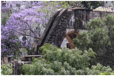
Acueducto de la ex hacienda del Chorrillo en la Ciudad de Taxco de Alarcón, Guerrero. Construido en la época del auge de la explotación platera en la colonia.
